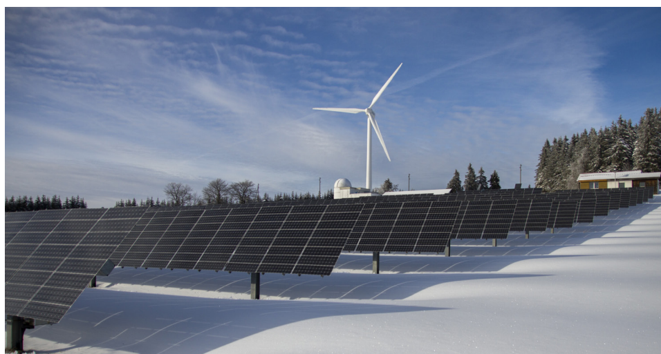
Un sistem fotovoltaic cu o turbină eoliană în fundal
